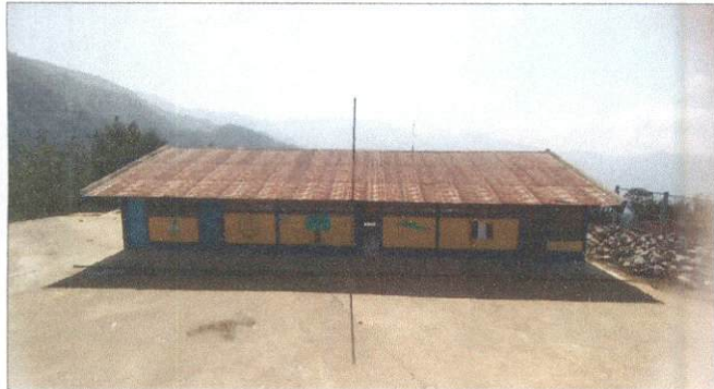
Foto1: sustitución de capote de lamina, Sustitución de lamina troquelada por lamina aluzinc calibre 26 y sustitucin de elementos de fijación.
